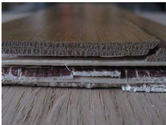
Abb. 1: Decklagenablösung nach partiellem Klebfugenbruch in der Mittellage eines 3-Schichtparketts
