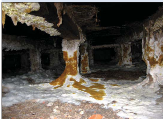
Abb. 1: Befall einer Balkon-Unterkonstruktion durch Echten Hausschwamm
